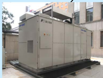
天然ガス燃料 (南ア)
